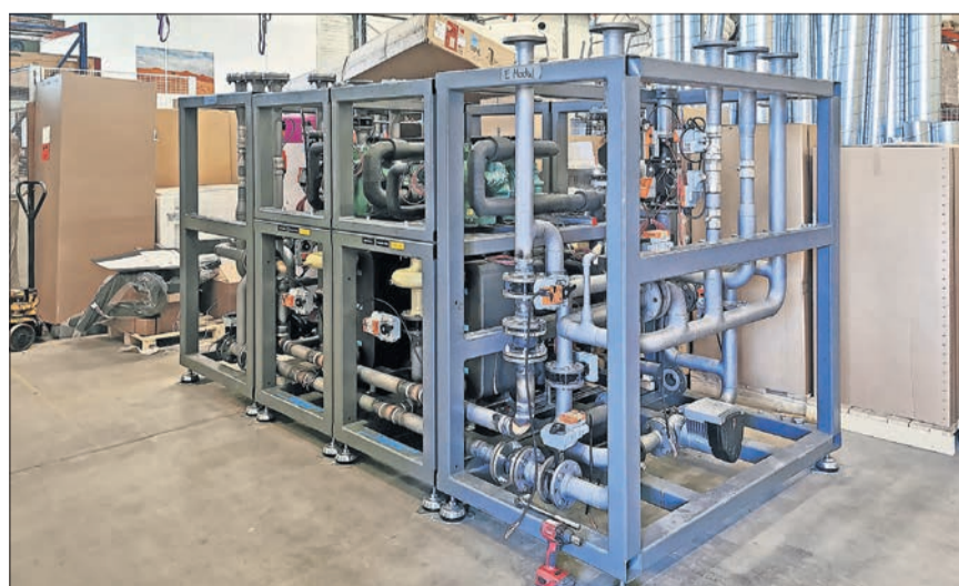
Bald startklar: Ende Oktober wird die erste Pilotanlage in Betrieb genommen.
